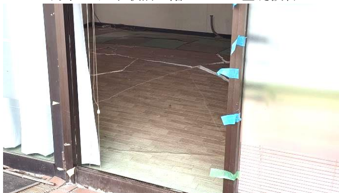
写真3 穴水駅前4階建ビルの基礎被害
