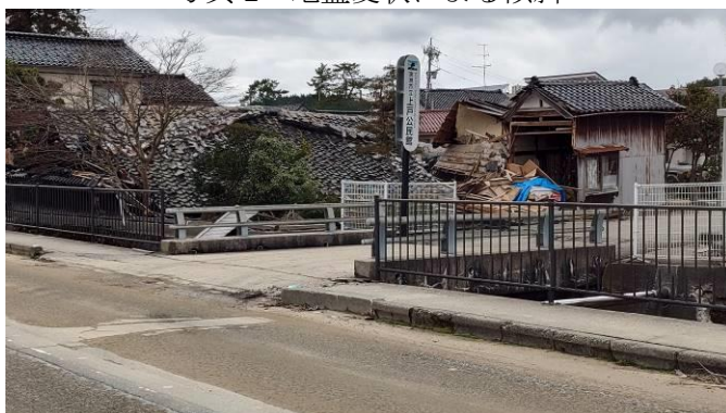
写真4 倒壊した木造住宅
