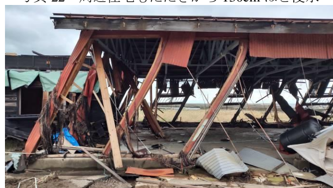
写真 24 漂流物衝突による S 造平屋の傾斜
