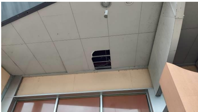
写真7 パチンコ店の天井落下
