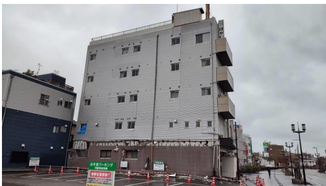
写真7 外装材脱落，基礎周り被害と建物傾斜
