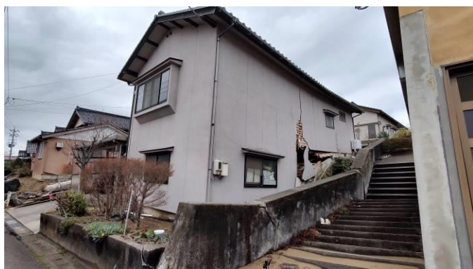
写真 11 地盤変状で上部構造に亀裂
