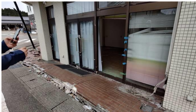
写真2 穴水駅前4階建ビルの基礎被害
