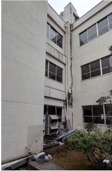
写真9 RC造3階建校舎の連絡棟取り合い部の亀裂 および1階柱梁接合部損傷
