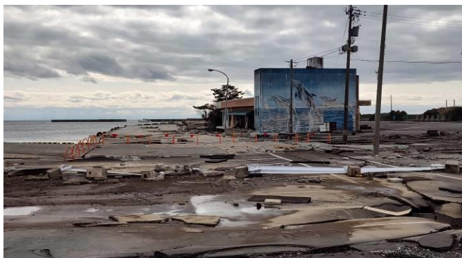
写真2 エプロン被害
