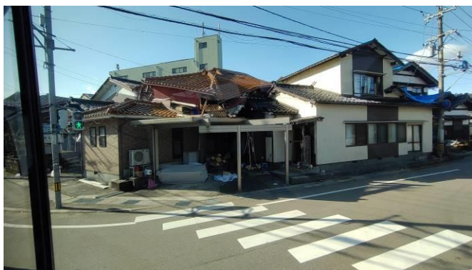
写真7 上層階の崩落被害
