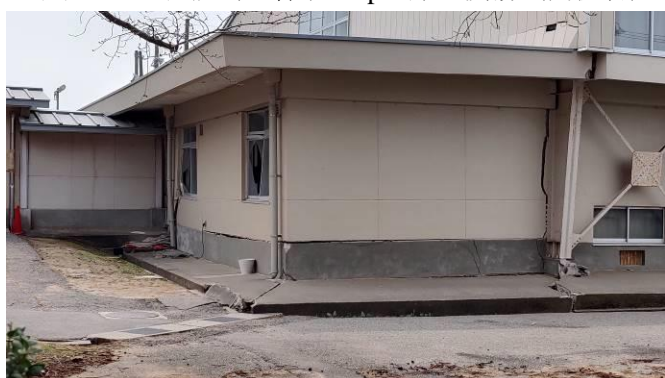
写真15 S造講堂の柱基礎部の損傷
