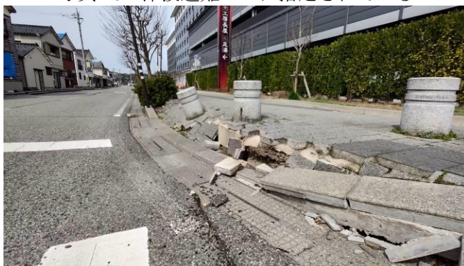
写真 20 周辺地盤の地盤変状
