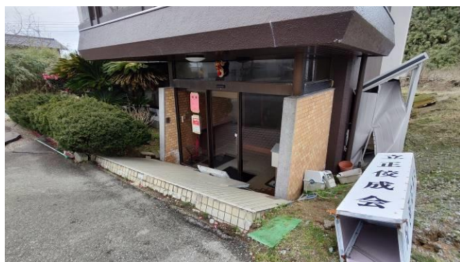
写真 13 出入口が大きく落ち込んでいる
