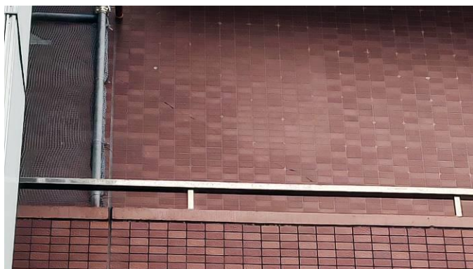
写真 24 5 病棟側 2 階壁のせん断ひび割れ
