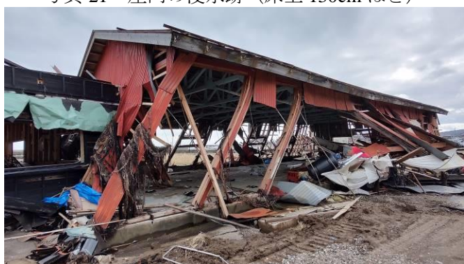
写真 23 漂流物衝突による S 造平屋の傾斜
