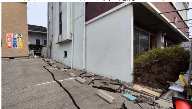
写真12 傾斜したRC造外構部の地盤変状
