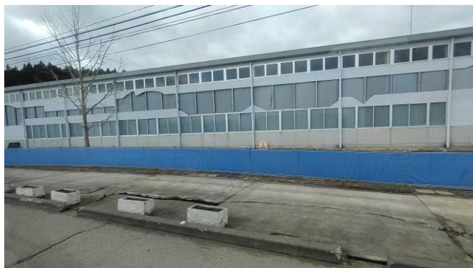
写真6 市街地から少し離れた場所にある外装材の剥がれ落ちた工場
