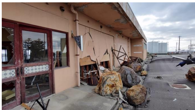
写真9 港と反対側（背面側）の壁の面外破壊
