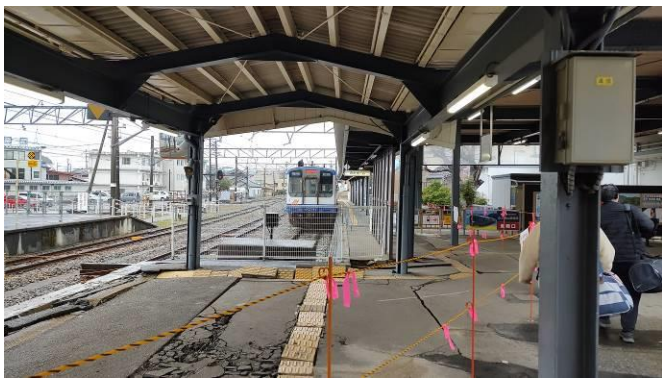
写真3 プラットホームの一部損壊
