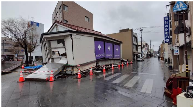
写真16 1層崩壊した店舗
