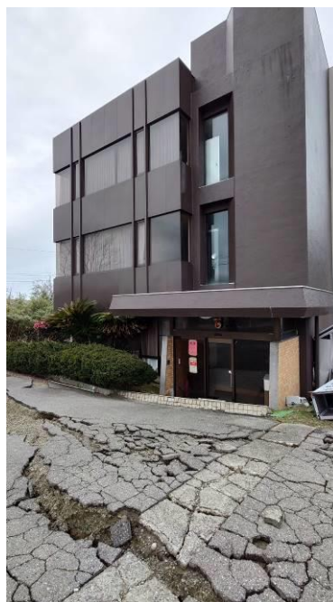
写真 14 駐車場部分が押し出されるように変状
