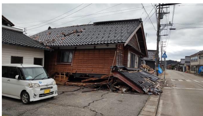
写真5 倒壊した木造住宅
