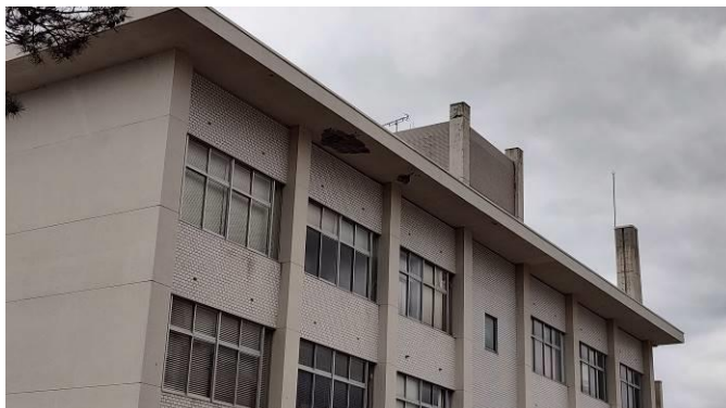
写真2 すず市民交流センター（劣化していたと思われる屋上スラブのコンクリート片が一部脱落）
