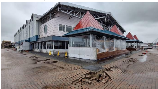
写真13 施設の海側外構部被害
