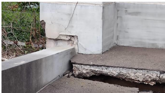
写真7 RC造3階建て地盤被害(穴水大宮前)
