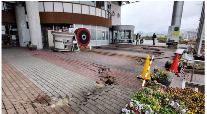
写真12 施設入口の地盤変状
