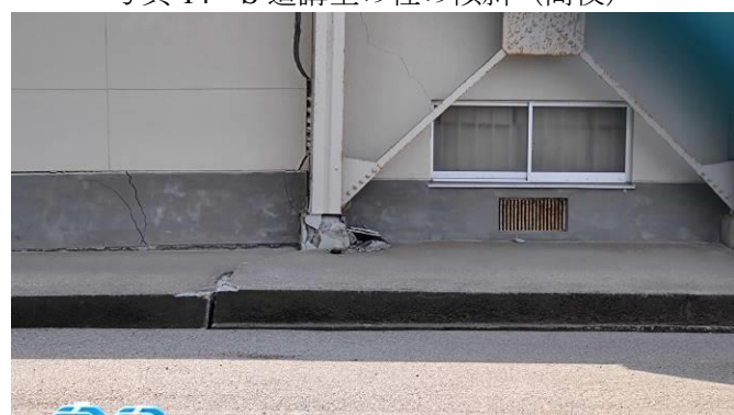
写真16 S造講堂の柱基礎部の損傷
