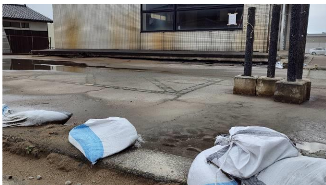
写真2 GLとFLに差（典型的な被害）
