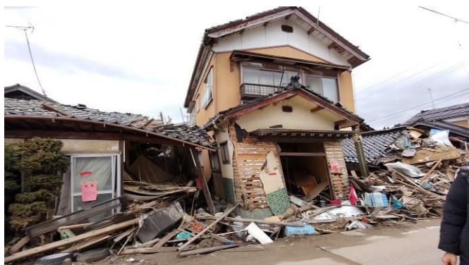
写真3 傾斜した住宅
