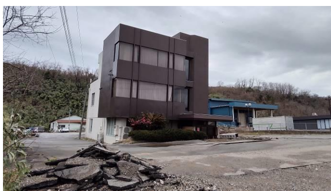
写真 12 RC 造建物の沈下および傾斜
