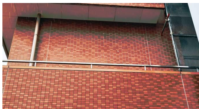
写真 24 5 病棟側 2 階壁に複数のせん断ひび割れ
