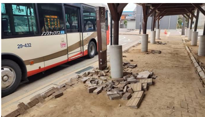
写真3 穴水駅前のバス乗り場の路盤被害
