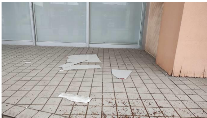
写真8 パチンコ店の天井落下
