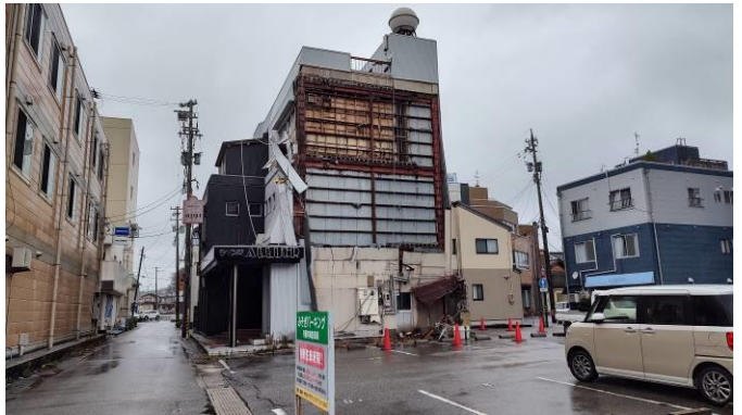
写真6 S造建物の外装材脱落
