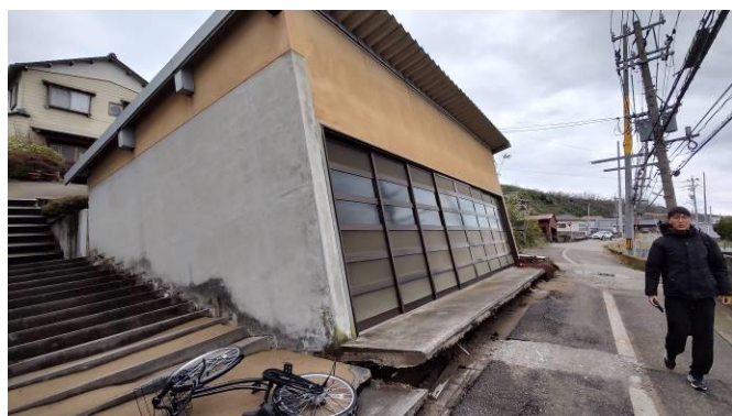
写真9 液状化で傾く建物
