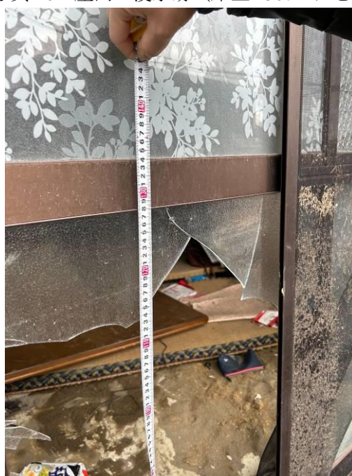
写真 22 周辺住宅もたたきから 130cm ほど浸水
