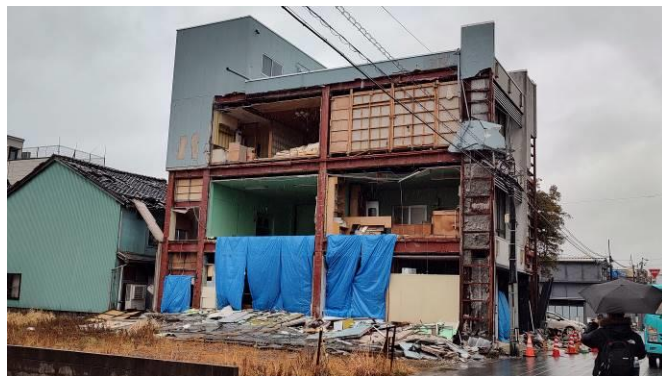
写真 17 S造建物外装材脱落
