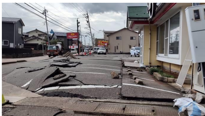
写真3 飲食店前駐車場の亀裂
