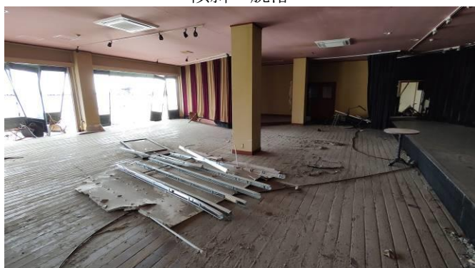
写真7 LGS スタッドと共に脱落した石膏ボード
