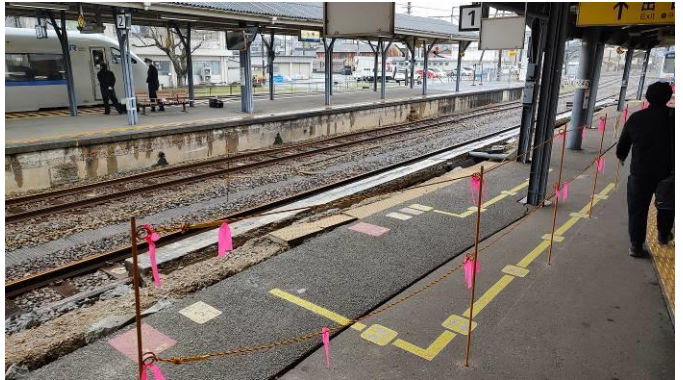
写真2 プラットホームの一部損壊
