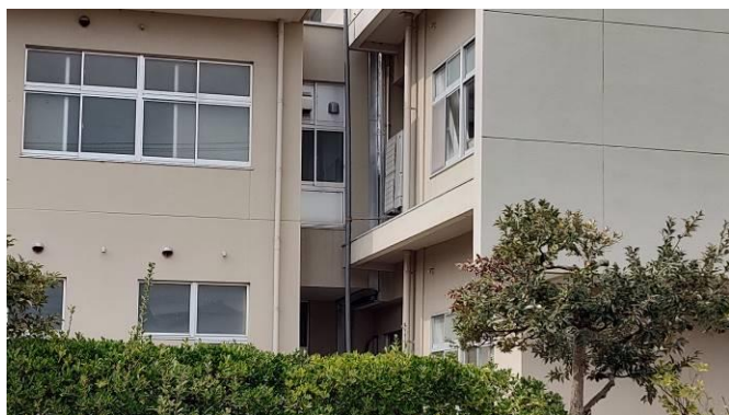
写真13 建物傾斜に伴う Exp.J 部の損傷 (高校舎)
