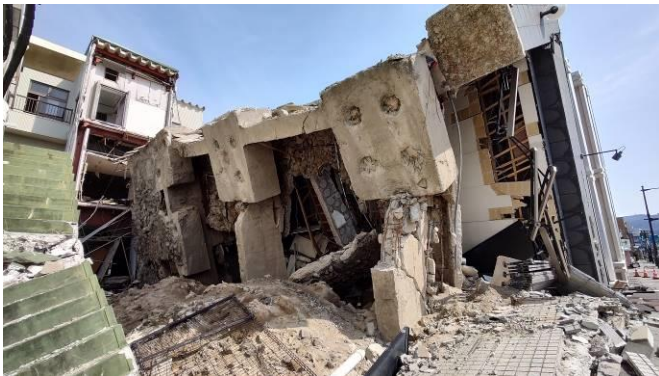
写真3 転倒したRC造ビルの基礎
