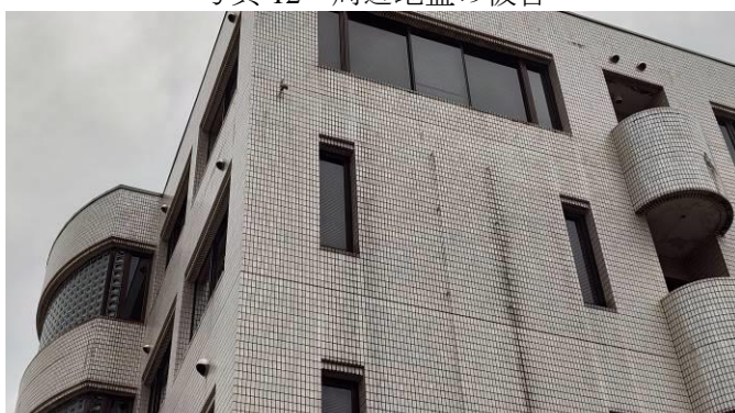
写真14 非常に薄く見えにくいが開口際にひび割れ
