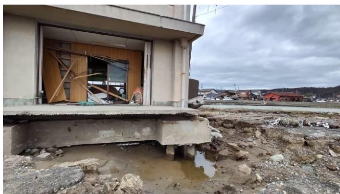
写真 19 洗堀による杭の露出
