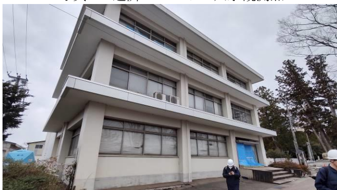
写真6 RC造3階建て地盤被害(穴水大宮前)
