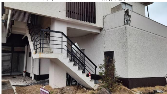
写真5 基礎の違いで上部構造取合部に生じた損傷
