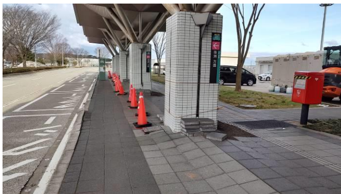
写真2 外構部の被害
