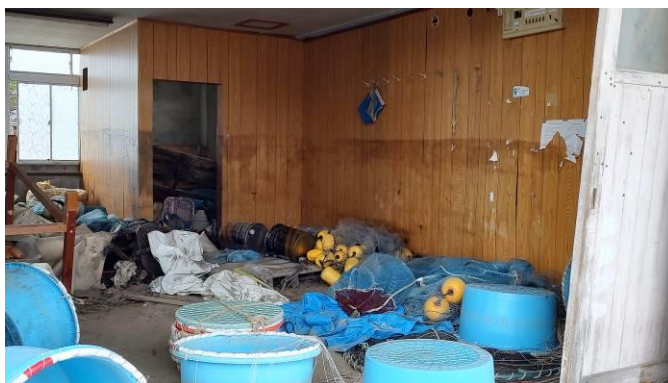
写真 20 屋内の浸水跡 (床上 130cm ほど)
