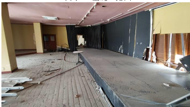
写真6 室内の浸水被害（石膏ボードが港側に脱落）
