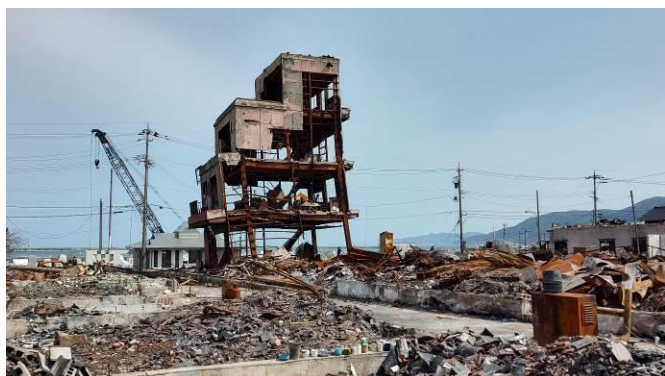
写真9 輪島朝市の火災跡
