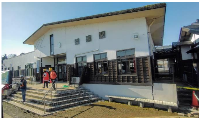
写真1 穴水駅舎の被害（基礎周りに多数）
