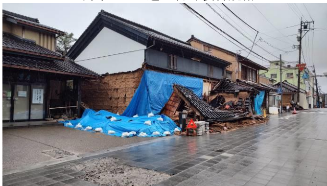
写真 20 土壁の建物被害
