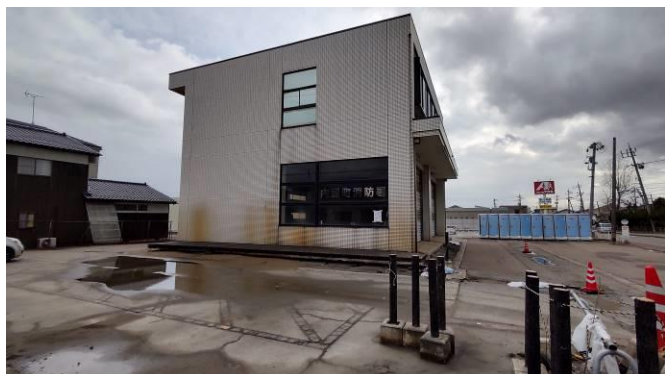
写真1 GLとFLに差（典型的な被害）
