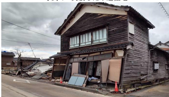
写真6 倒壊した住宅と傾斜した住宅
