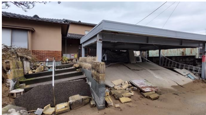
写真6 建物入口の地盤変状
