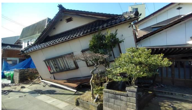
写真5 1層崩壊した木造住宅
