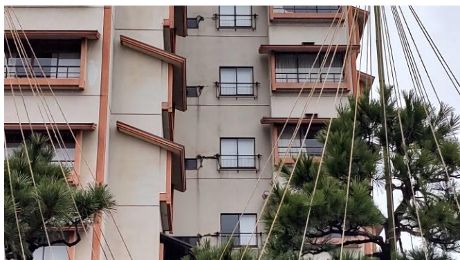
写真9 壁の開口部周辺にひび割れ多数発生
