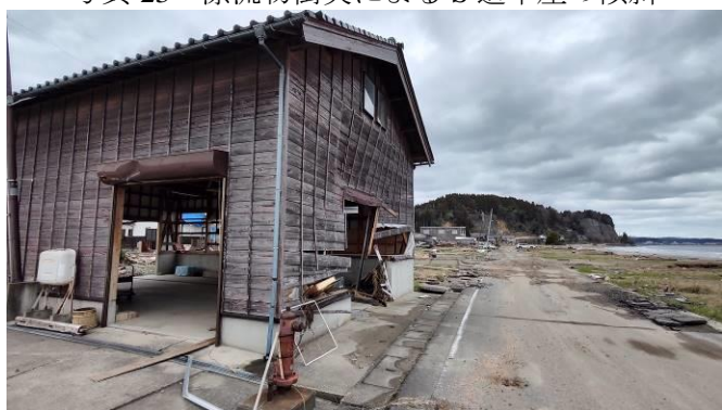
写真 25 木造倉庫の壁面面外破壊
