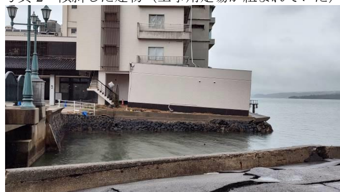
写真4 付帯構造部が海側に傾斜
