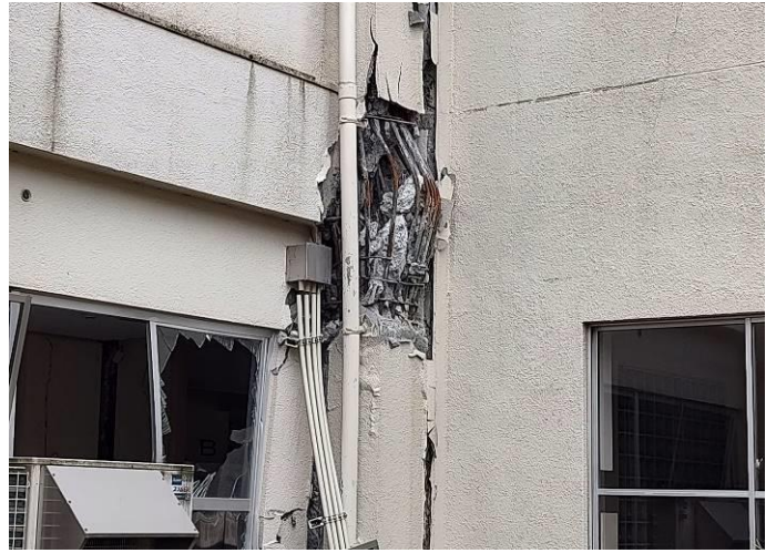
写真10 1階柱梁接合部損傷 (主筋：丸鋼，接合部せん断補強筋：なし)
