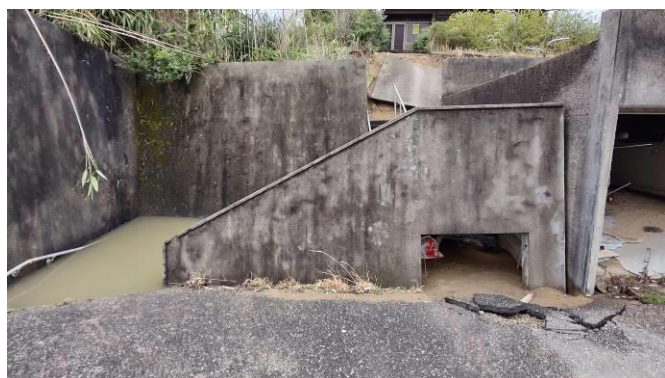
写真7 建物へのアプローチを遮る地盤変状
