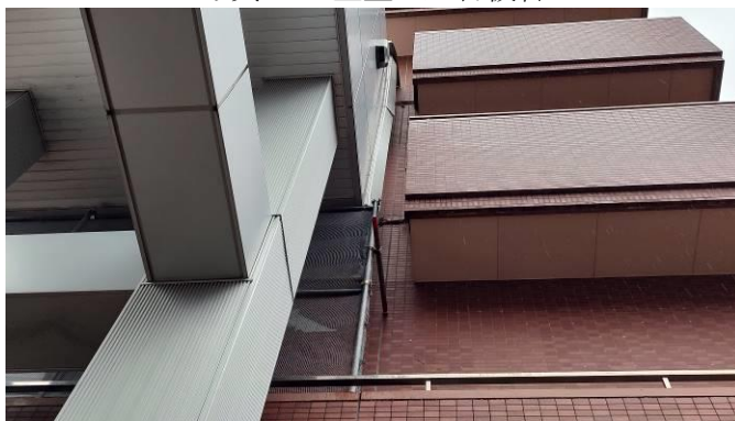
写真 22 連絡橋接続部の被害
