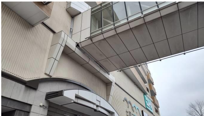
写真5 渡り廊下ジョイントカバーの損傷
