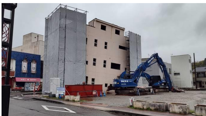
写真2 傾斜した建物（工事用足場が組まれていた）
