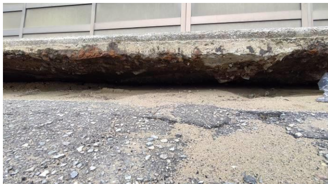
写真10 傾斜した建物はベタ基礎
