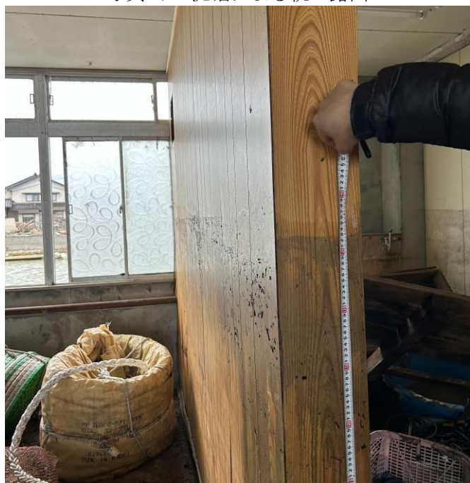
写真 21 屋内の浸水跡 (床上 130cm ほど)
