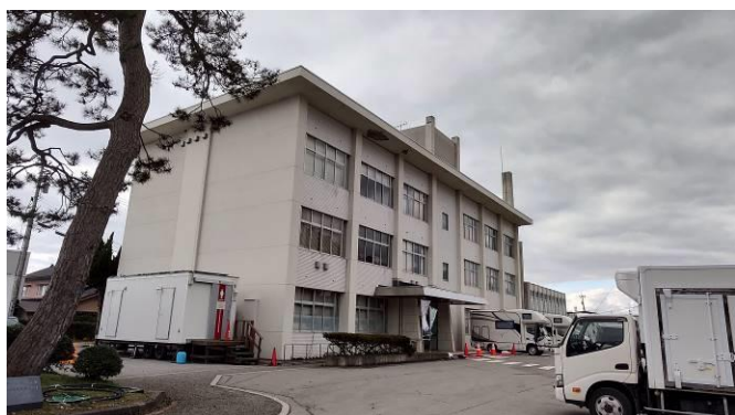
写真1 すず市民交流センター（劣化していたと思われる屋上スラブのコンクリート片が一部脱落）
