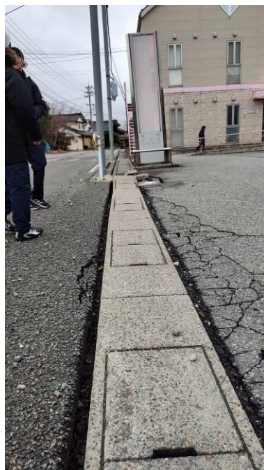
写真2 地盤変状による傾斜
