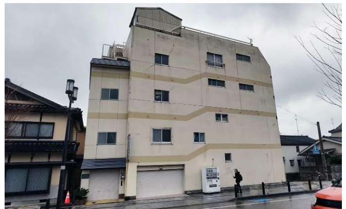
写真10 RC造建物開口部隅角部のひび割れ
