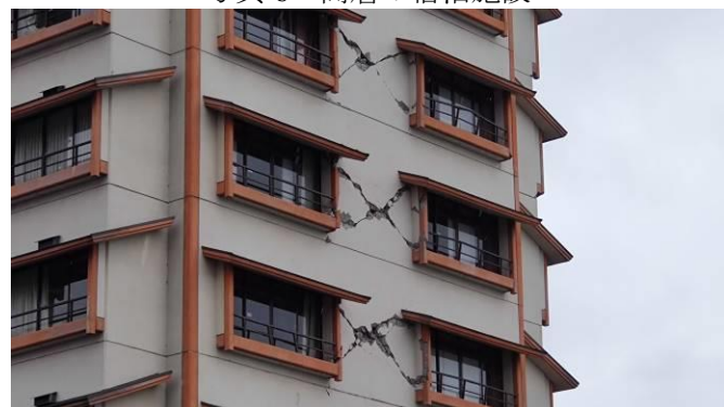
写真8 せん断ひび割れの様子
