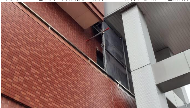
写真 23 連絡橋接続部の被害
