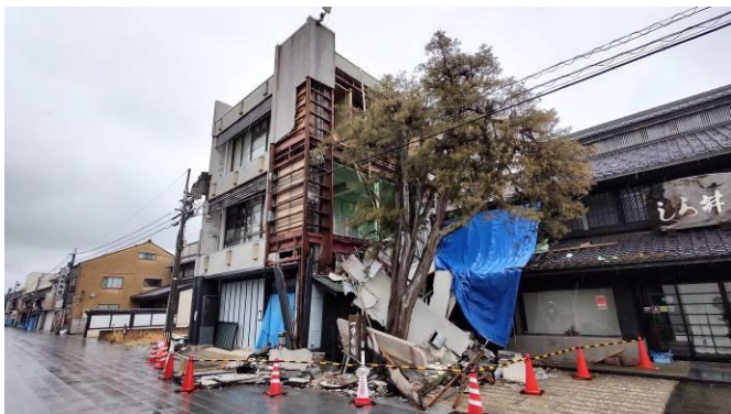
写真 17 S造建物外装材脱落
