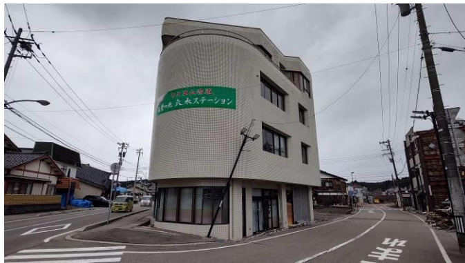
写真1 穴水駅前4階建ビルの基礎被害
