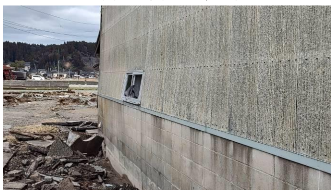
写真 17 漁港荷揚げ施設の外装材面外変形
