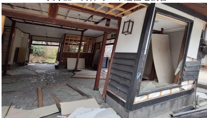
写真 24 傾斜した木造建物（ホールダウン金物なし）
