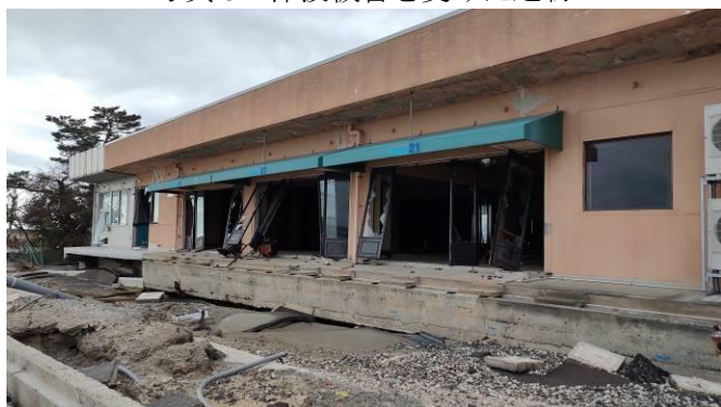
写真5 港に面した開口扉は全て屋外方向（港側）に傾斜・脱落
