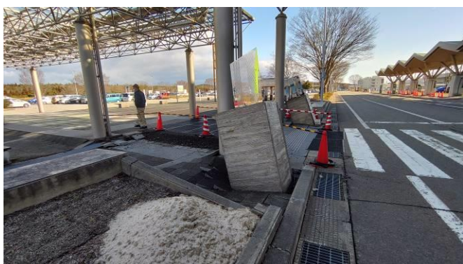
写真3 外構部の被害
