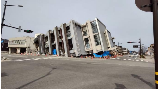
写真1 転倒したRC造ビル（1972年竣工）
