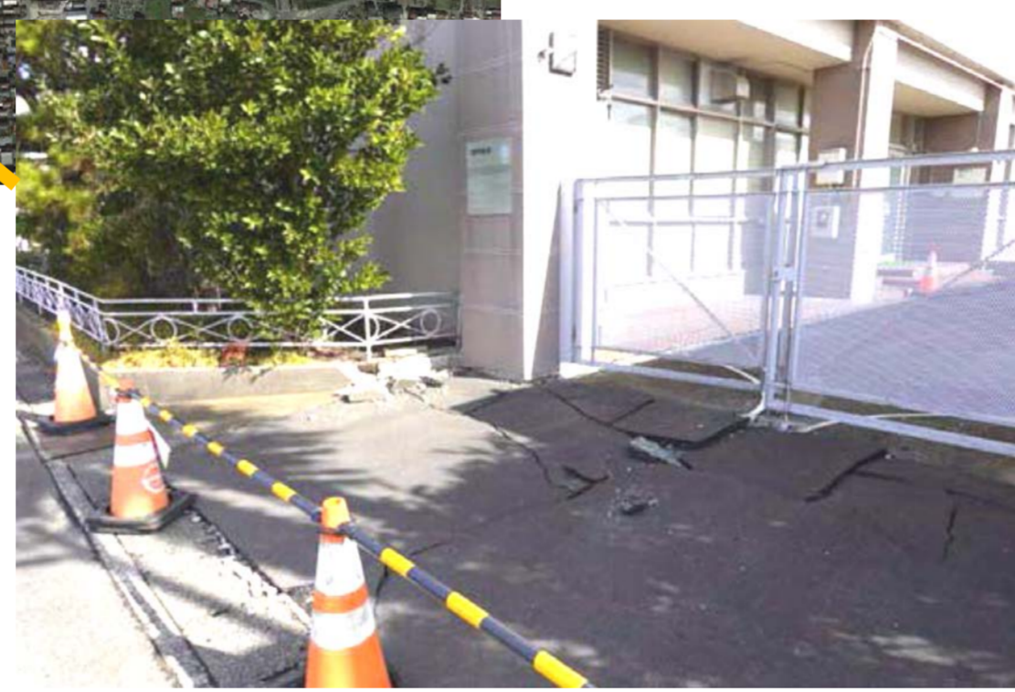
宇田川沿いの敷地で地盤変状
