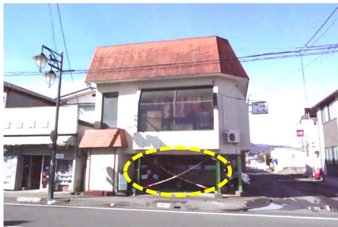
ブレースの座屈
