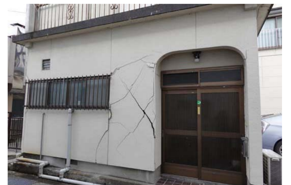
木造家屋の外装材損傷
