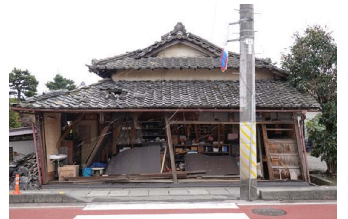
木造倉庫の傾斜
