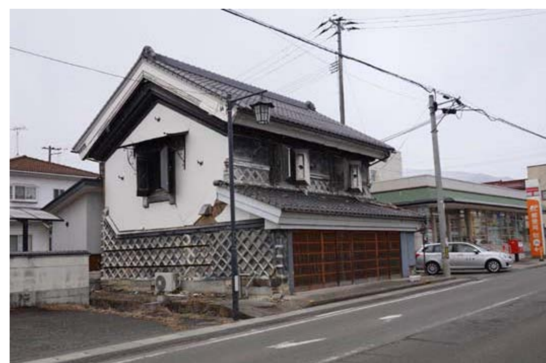
蔵の壁に亀裂
