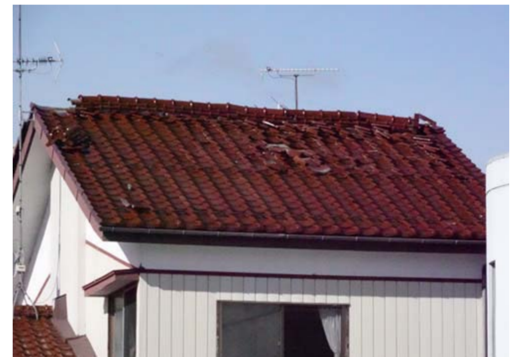
屋根瓦の脱落
