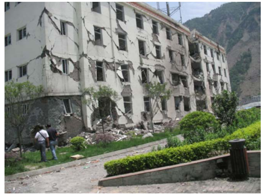
▲RC造建物の地震被害例（中国）
