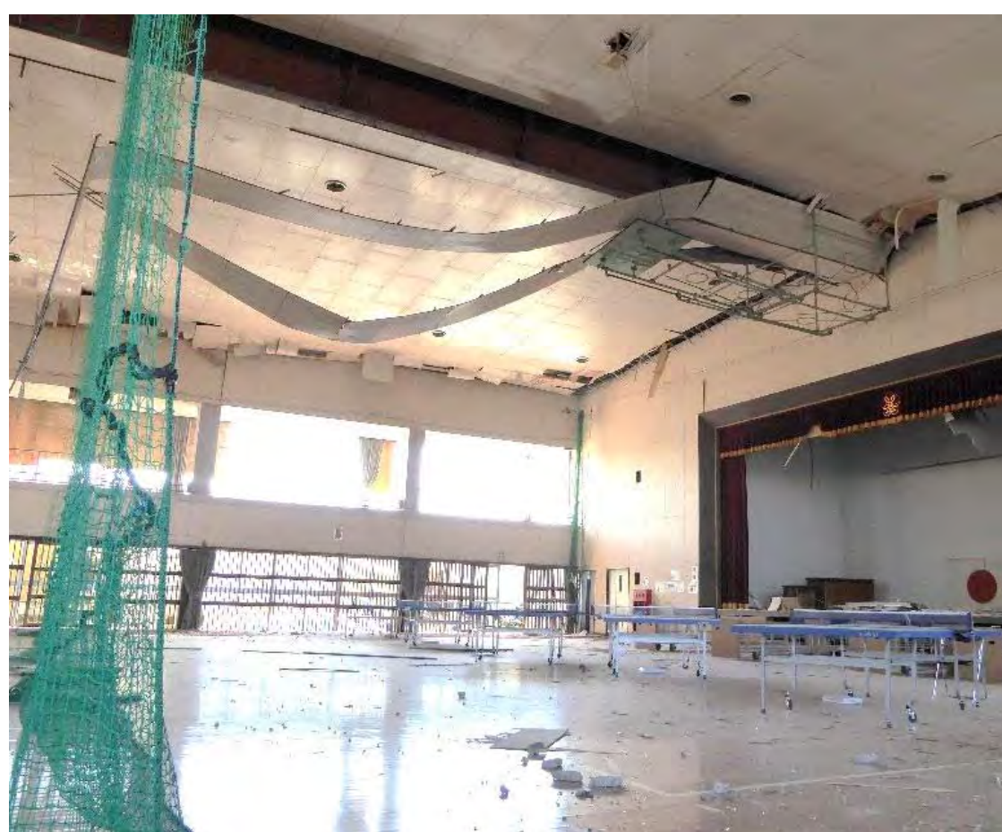
写真1 天井材落下被害
