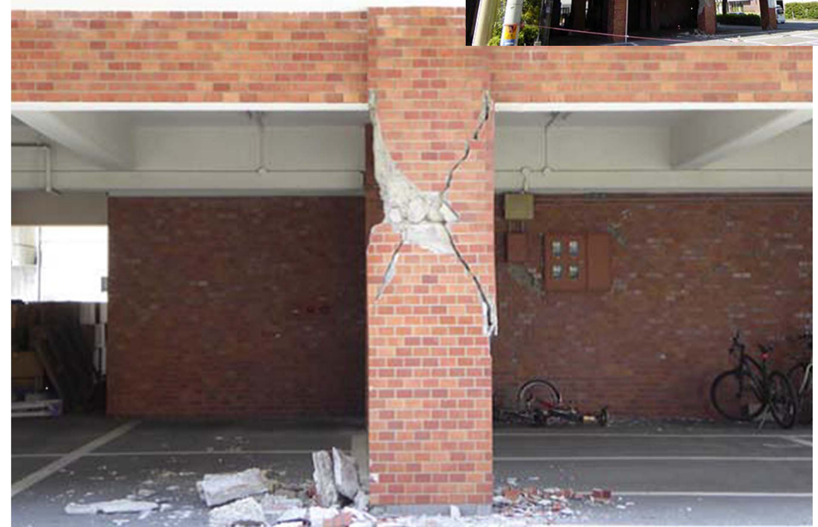
写真2 中央柱がせん断破壊
