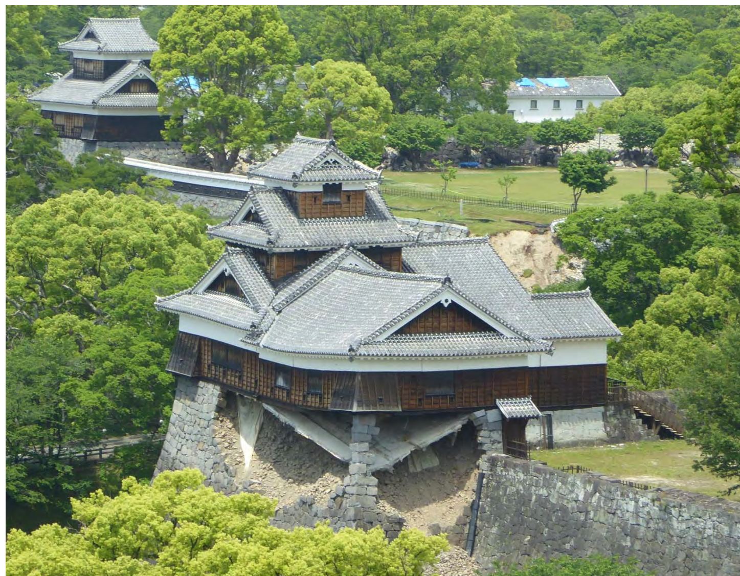
写真1 飯田丸5階櫓下部石垣の崩落
