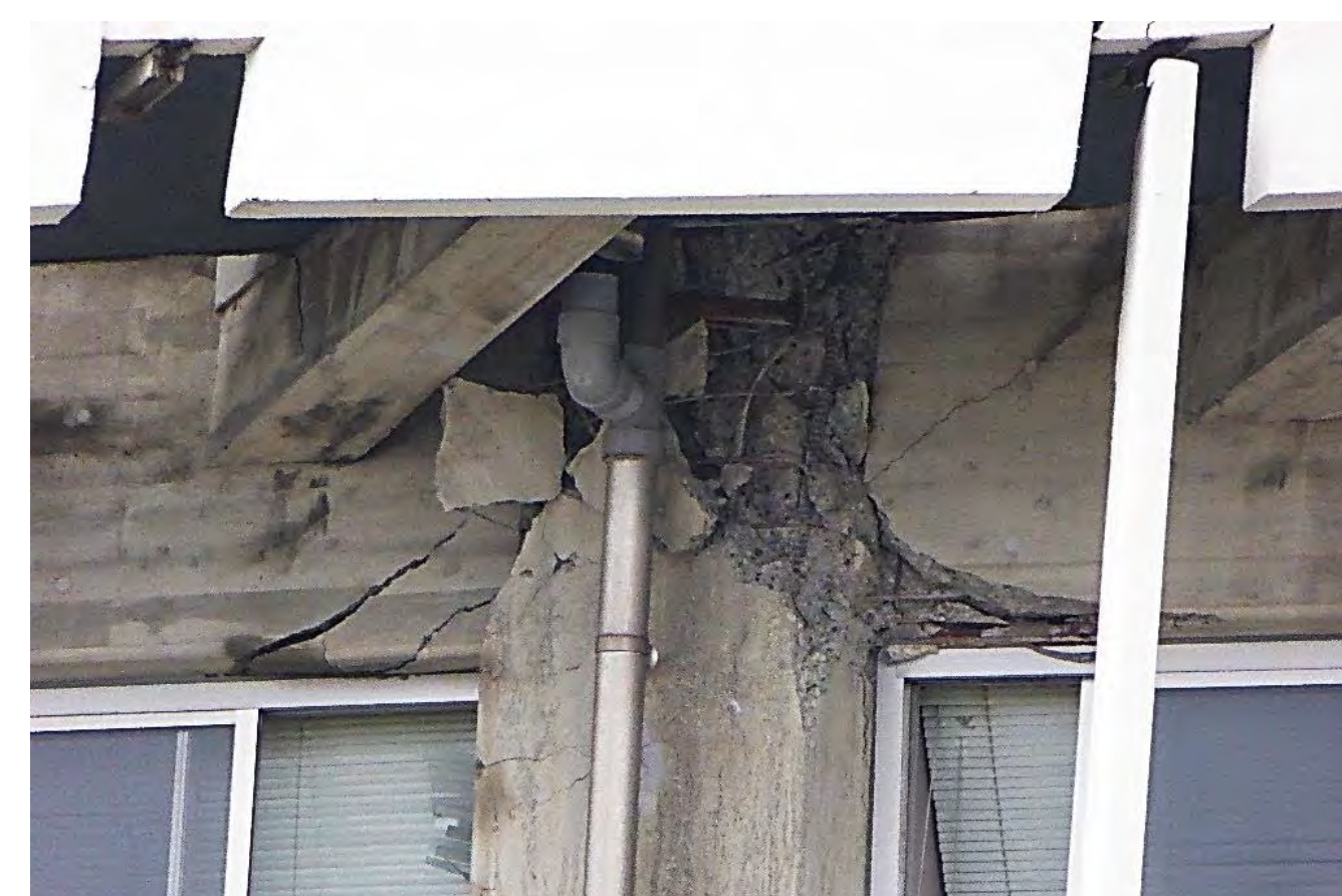
写真3 4階柱梁接合部被害
