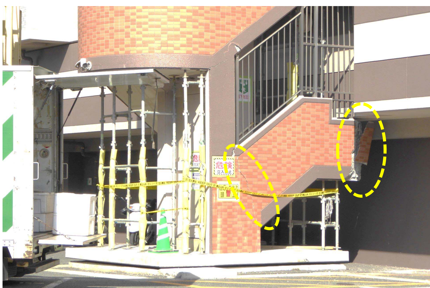
写真1 2階と連動した外階段が1階部分と衝突
