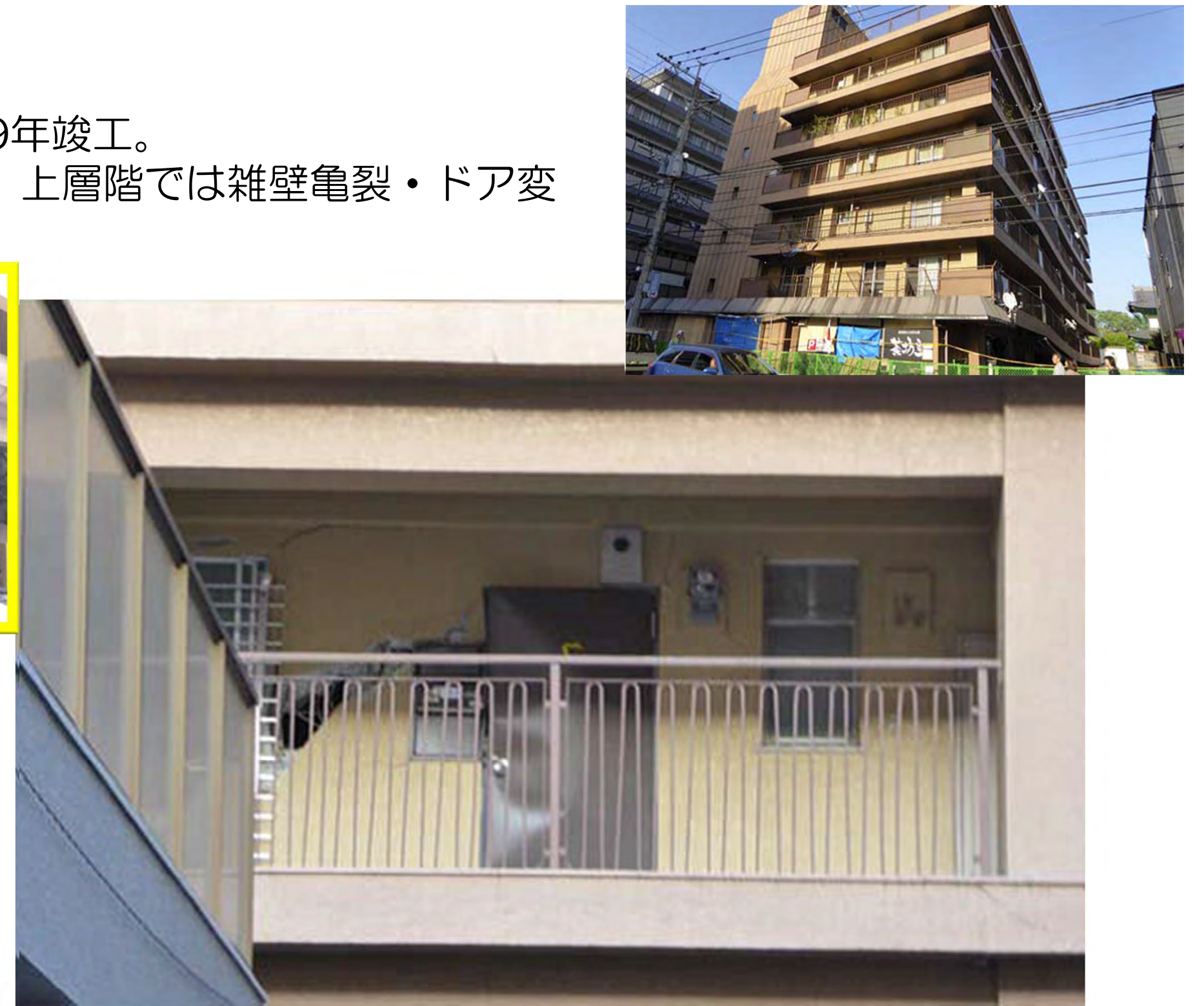
写真2 雑壁の亀裂とドア変形
