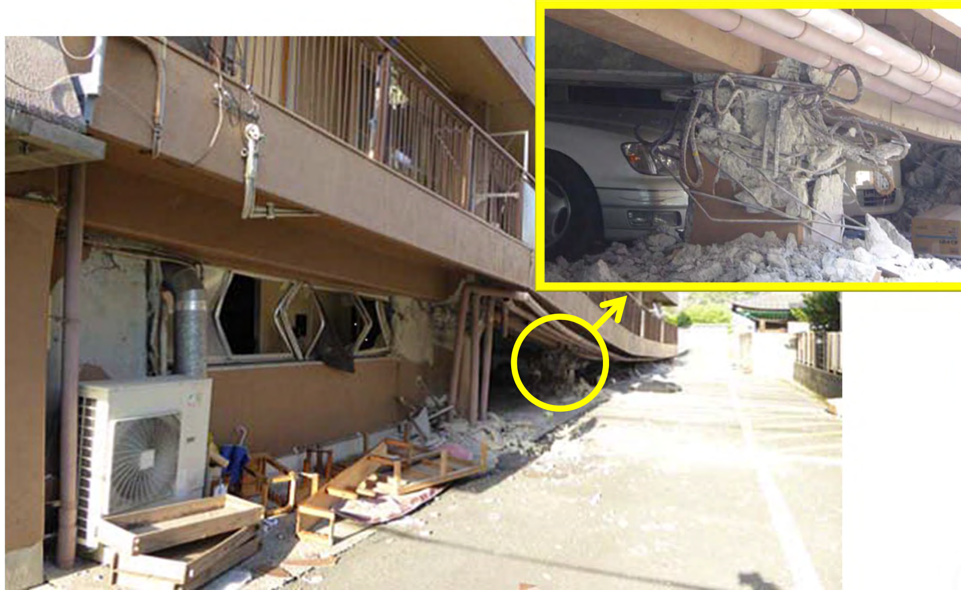
写真1 ピロティ部分の層崩壊
