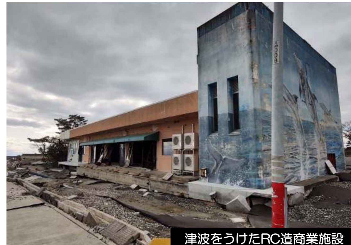
エプロン被害
